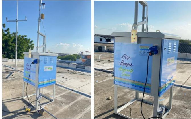
Imagen: Shelter para equipo de monitoreo de material particulado. Ubicación: Punto EDUMAS
