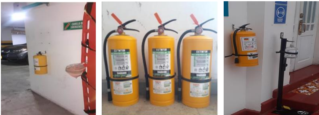
Imagen. Extintores recargados
